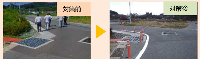
▲（主）大船渡広田陸前高田線 広田工区（陸前高田市） 歩車分離による巻き込み防止対策
