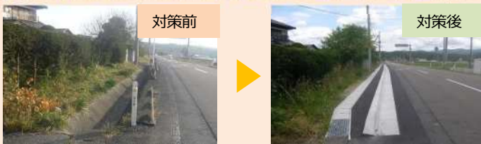
▲ 国道456号 江刺大日工区（奥州市） 側溝蓋掛けによる歩行空間の確保
