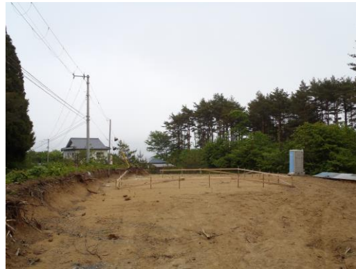
説明：造成工事完了後の用地の様子 （用地の北側から撮影）
