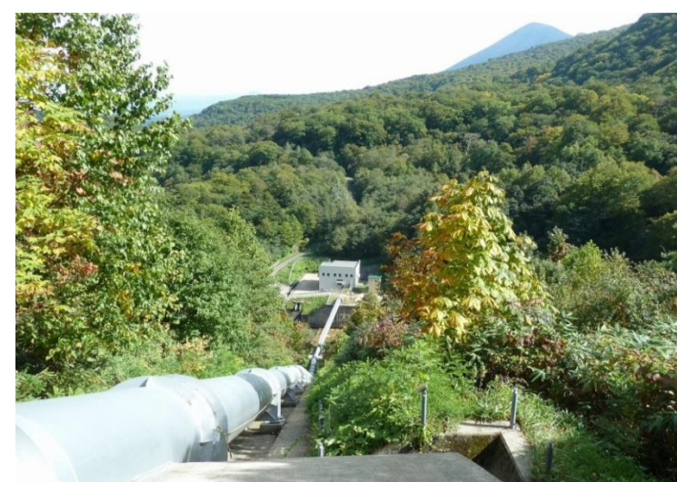
⑨ 北ノ又第二発電所
