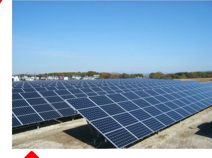
1 相去太陽光発電所
