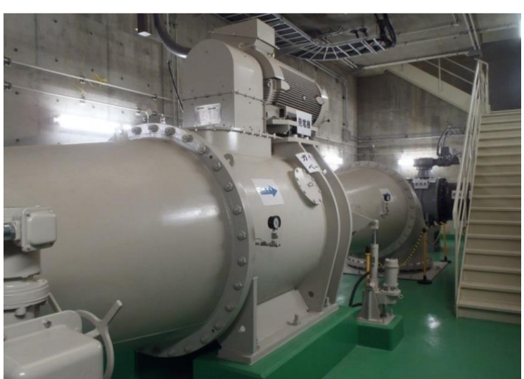
⑮ 胆沢第四発電所
