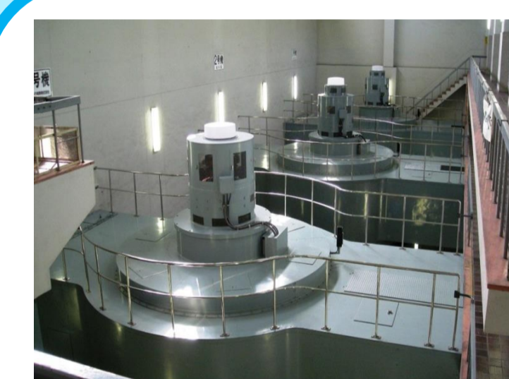
④ 仙人発電所
