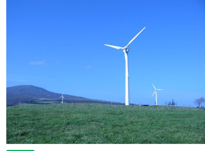
1 稲庭高原風力発電所
