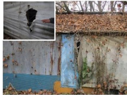
ロールカーテンの破損
