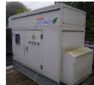
非常用発電機
