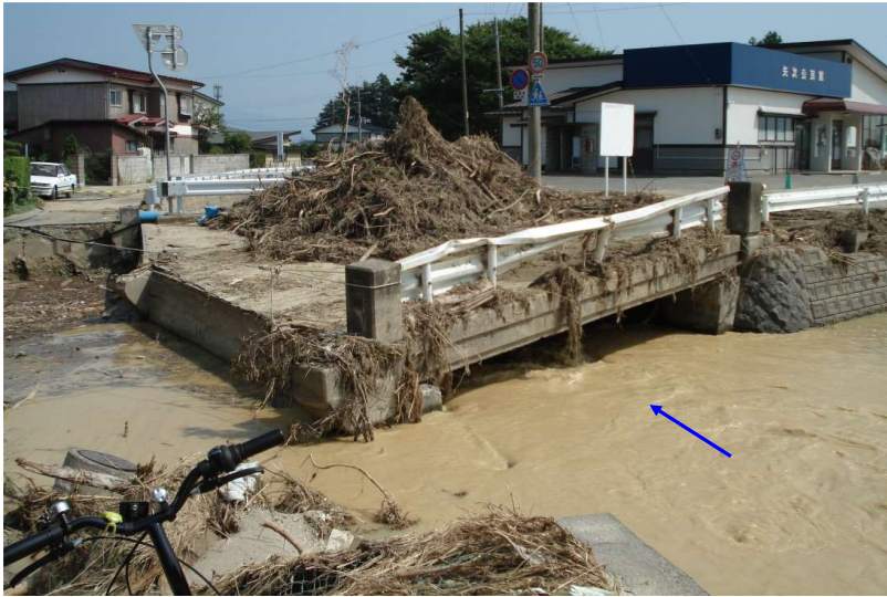
【写真① 岩崎川橋（H25.8被災直後）】
