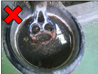
図 3-2 汚れた水槽 掃除しましょう
