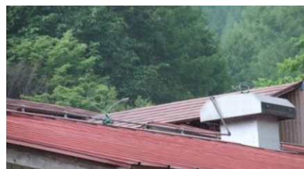
図 6-6 屋根のスプリンクラー
