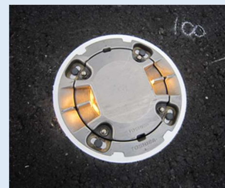
※ 灯器の点灯状況
