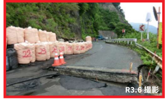
R3.6 撮影 道路部では約30cmの段差が発生
