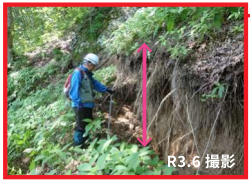
R3.6 撮影 上部では2m近くの段差が発生
