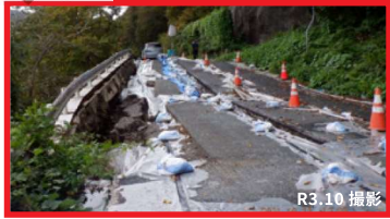
R3.10 撮影 道路の沈下と擁壁の転倒が発生
