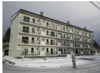
老朽化した公営住宅
