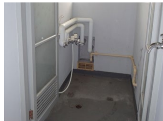
設備の老朽化
