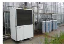
ガスヒートポンプ（室外機）
