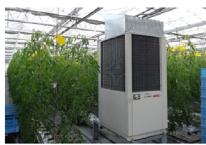
地下水熱源ヒートポンプ（室内機）
