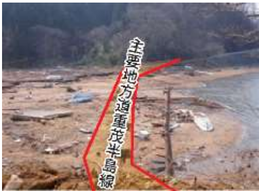
【整備前の県道の被災状況】
