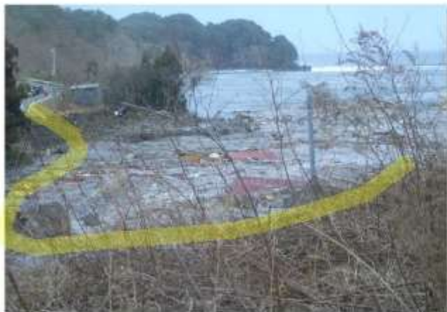
【整備前の県道の被災状況】
