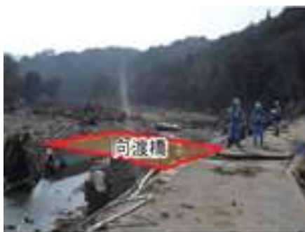
【整備前の県道の被災状況】
