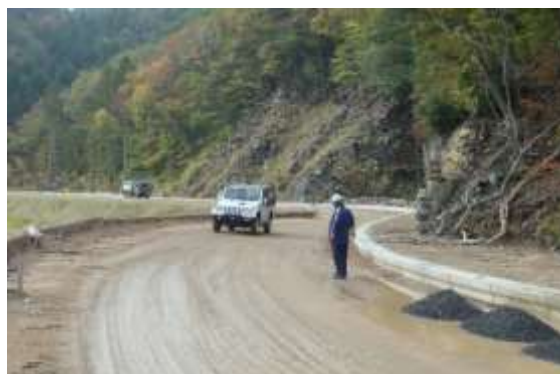
【令和元年台風第19号で工事区間を緊急輸送道路として使用 令和元年10月撮影】
