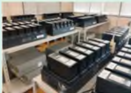
バッテリー保管・充電施設
