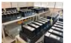
ドローンのバッテリー充電施設
