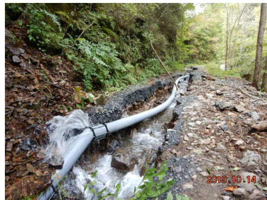
【パイプラインの露出・破損】
