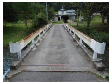
【老朽化が進む農道橋】
