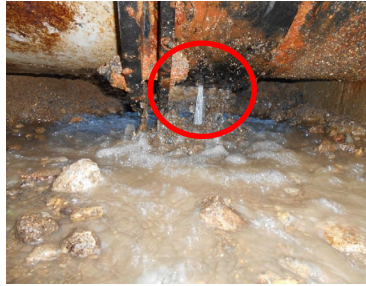
【劣化によるパイプライン継手の腐食】
