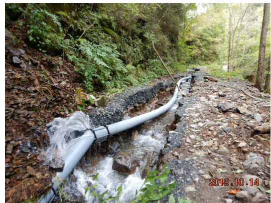
【パイプラインの露出・破損】
