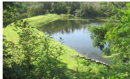
【対策が必要と診断されたため池】
