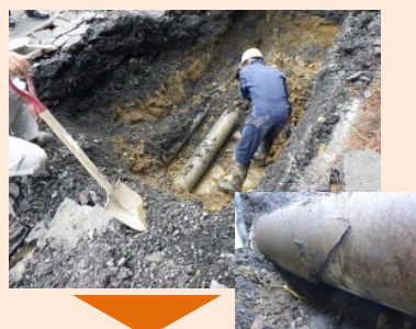
【パイプラインの突発事故への対応状況】
