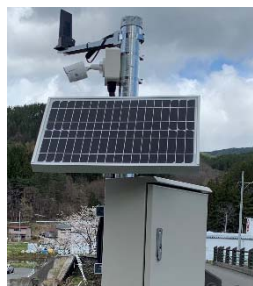
簡易型河川監視カメラ(県)
