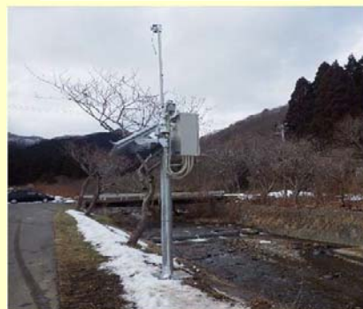
簡易型河川監視用カメラ
