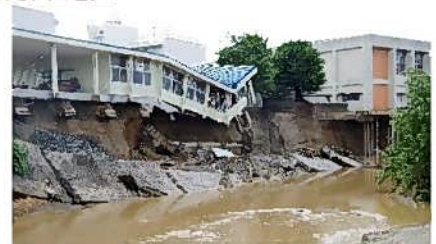
河岸侵食に伴う家屋倒壊等
