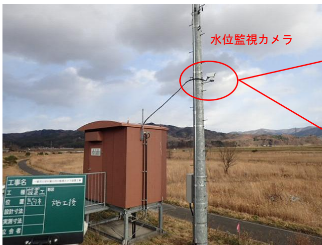
水位監視カメラの設置状況
