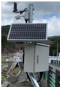
簡易型河川監視カメラ(県)
