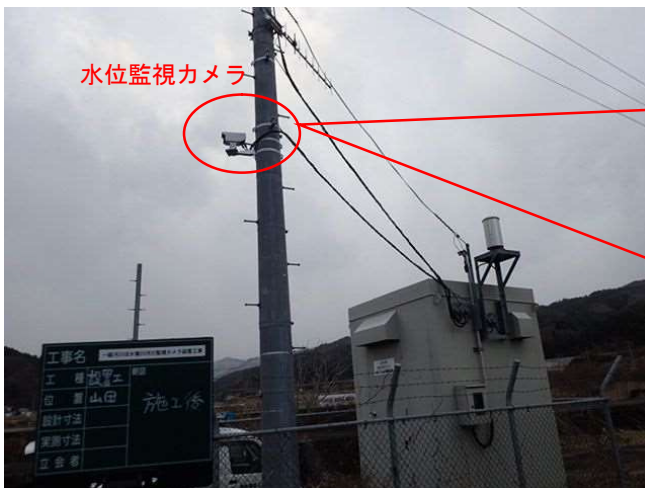
水位監視カメラの設置状況
