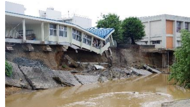
河岸侵食に伴う家屋倒壊等
