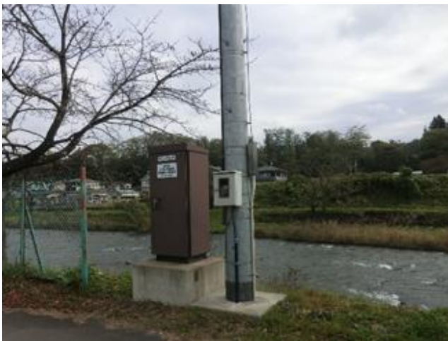
水位計設置状況
