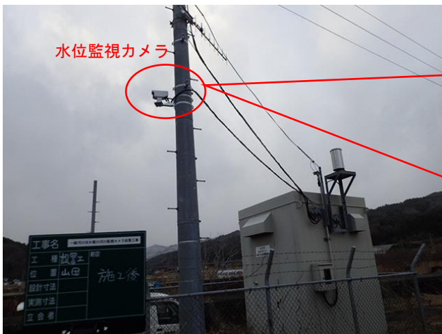
水位監視カメラの設置状況
