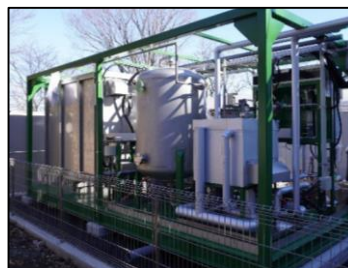
メタン発酵バイオガス発電設備
