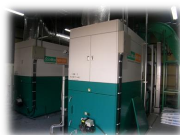
木質チップボイラ
