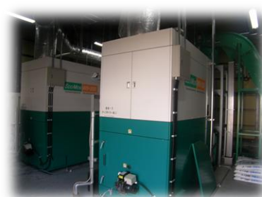
木質チップボイラ
