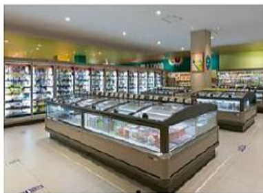
スーパーマーケット・冷凍冷蔵ショーケース
