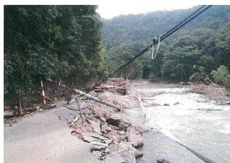
写真：平成28年台風第10号による道路被害の状況（岩泉町）
