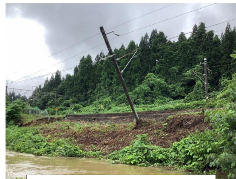
R5.7.14秋田県内の大雨被害の状況
