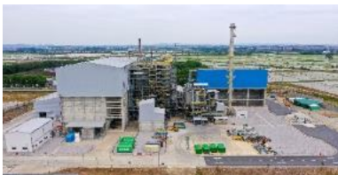
廃棄物発電（ベトナム）
