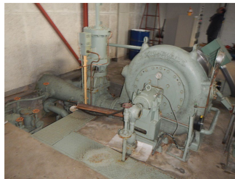
たかむろ水光園の小水力発電機（150 kW）
