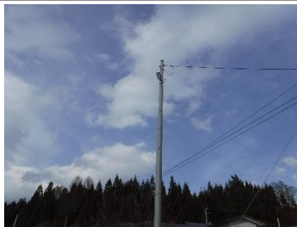
防犯灯LED化(八幡平市)
