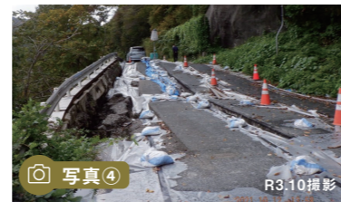
道路の沈下と擁壁の変状が発生
