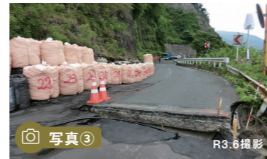
道路では約30cmの段差が発生
