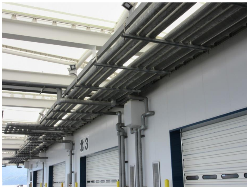
【岸壁上屋配管】
