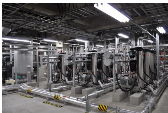
【製氷施設（内部）】
