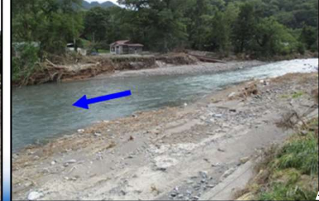
⑦右岸側の溢水被災状況
