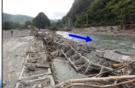
⑤右岸側の溢水被災状況
