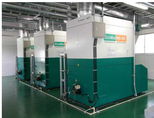
木質バイオマスボイラー
