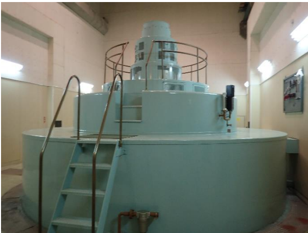
胆沢第二発電所 発電機
