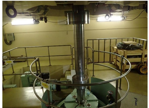
入畑発電所 水車設備
