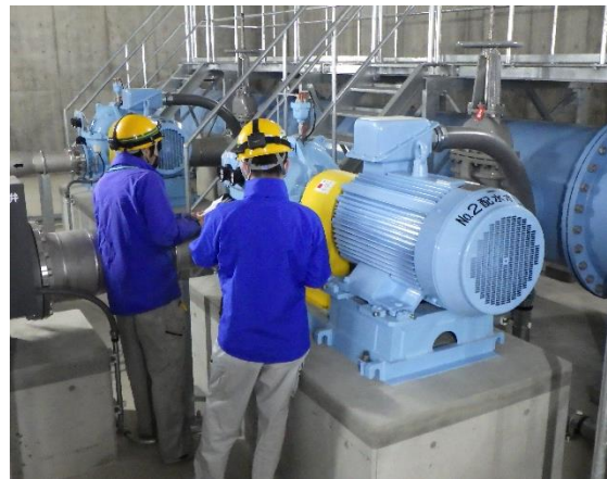
配水ポンプ設備点検の様子
