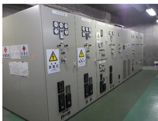
第三浄水場高圧受電設備
