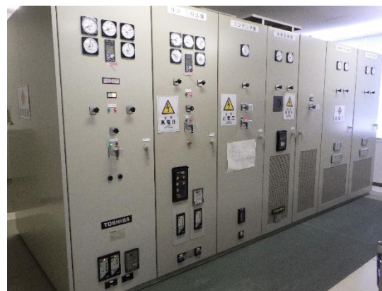
金ヶ崎ろ過施設(第二期) 高圧受電設備
