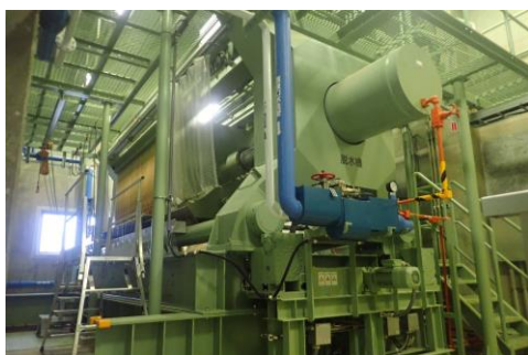
第三浄水場 加圧脱水機(更新後)
