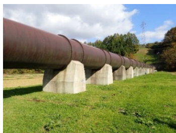
岩洞第二発電所濁川サイフォン
