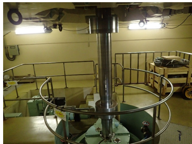
入畑発電所 水車設備
