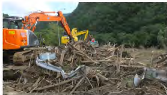
支障となる流木堆積(乙茂地区)
