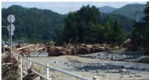
橋梁の流木被害状況(田中橋)
