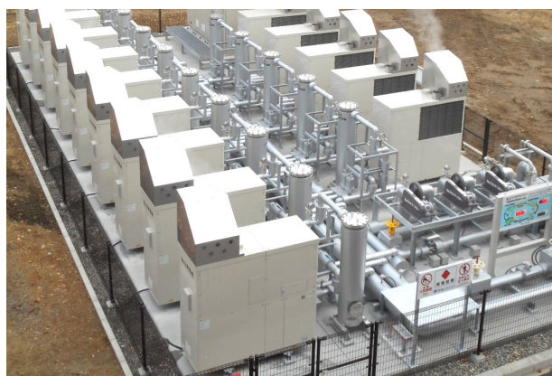
ガスエンジン発電設備（北上浄化センター）
