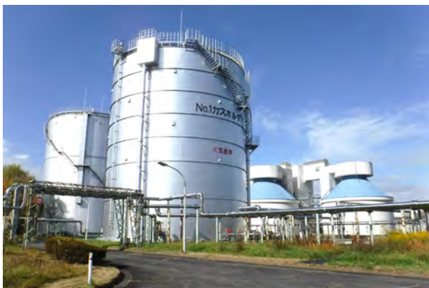
消化ガスタンク（手前）と 汚泥消化タンク（奥）
