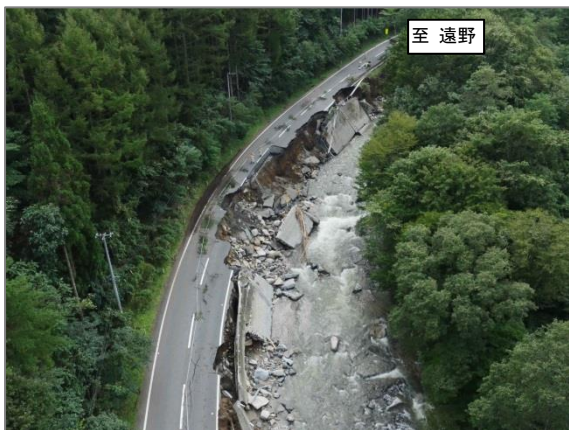
(被災時: 河川出水により道路が流出)
