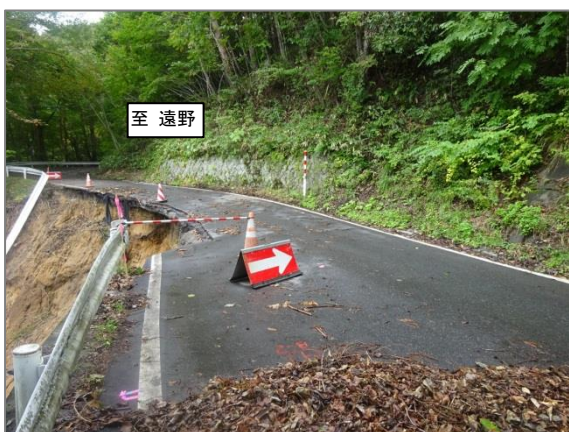
(被災時: 路面排水により路肩・路床等が決壊)
