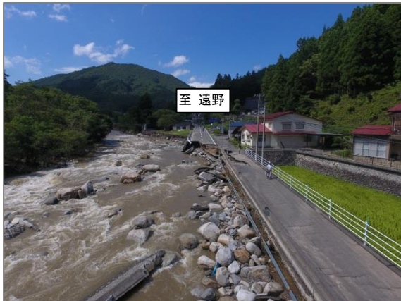
(被災時: 河川出水により道路が流出)
