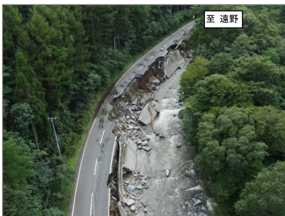
(被災時: 河川出水により道路が流出)
