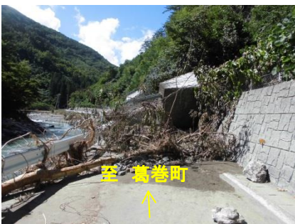
⑦ロッキーパー付近の被災状況
