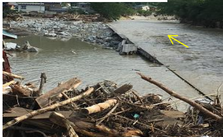
④ 門地区の被災状況
