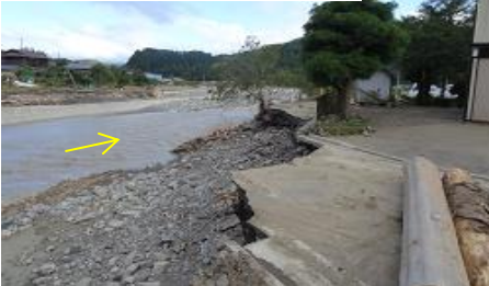
⑤ 門地区の被災状況
