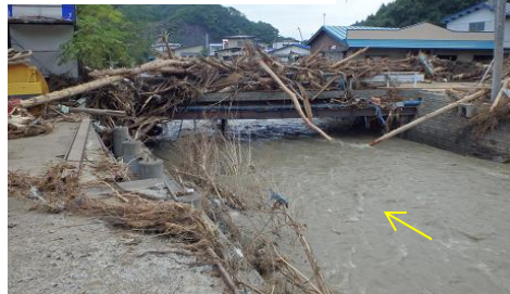
③ 門地区の被災状況
