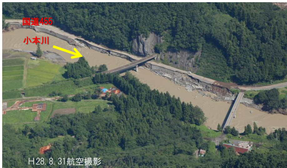
② 国道455号道路兼用護岸被災状況
