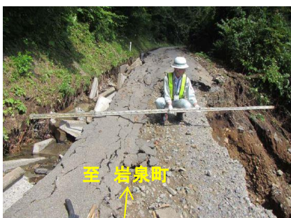
⑩冬期通行止ゲート付近道路流出
