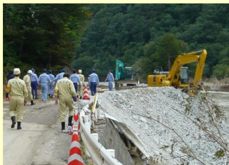
国道 455 号の被災状況
