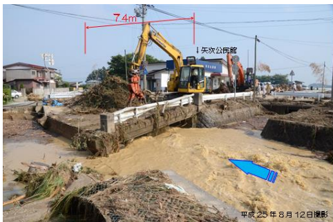
被災直後の岩崎川橋(旧橋)
