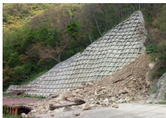
崩壊土砂堆積状況
