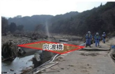
千鶏地区：道路崩落
